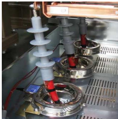
Elektronik Akım Trafosu
